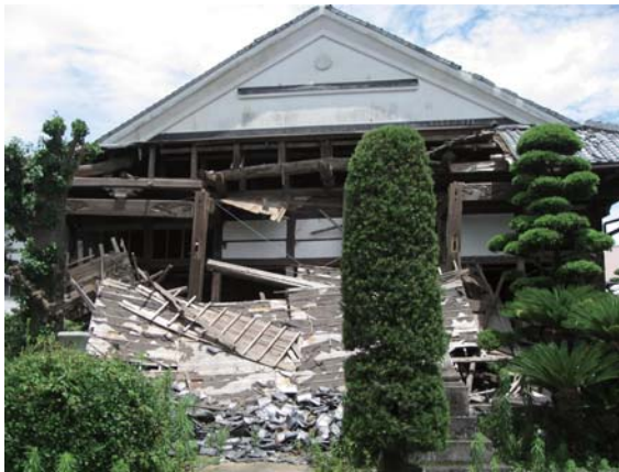
本堂の軒が崩落した光恩寺
