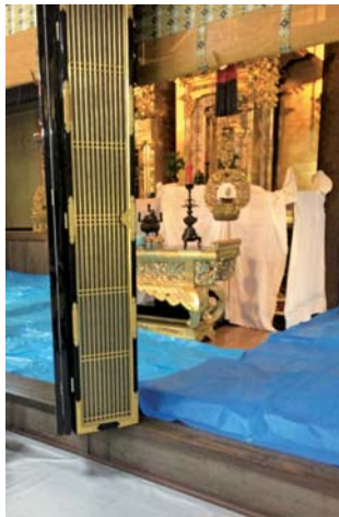
天井板が破損し応急処置(海南組了賢寺)
