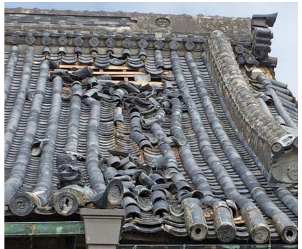
屋根に穴が空いた本堂(御坊組光明寺)
