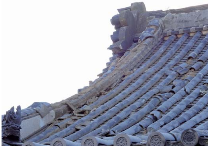
瓦が飛散した本堂の屋根(御坊組常照寺)
